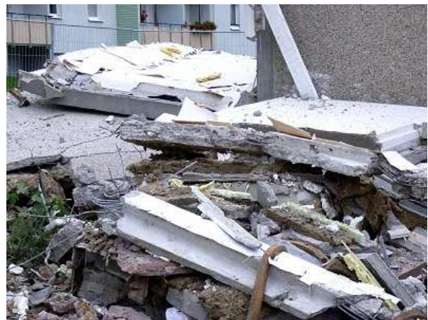
Am Boden zerstörte Außenwandplatten – dabei sichtbar die Tragschale und die Dämmschicht, bestehend aus Mineralwolle
