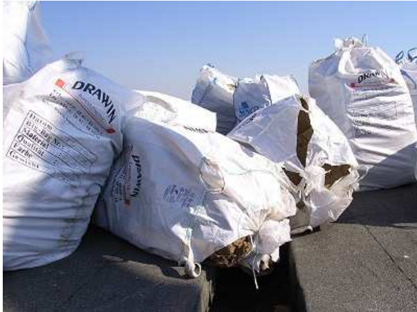
Im Bereich der innen liegenden Dachentwässerung abgestellte Big-Bags, gefüllt mit Mineralwolle.
