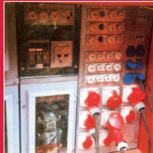
Baustromverteiler mit Sicherheitsmängeln – fehlende Schraubkappen
