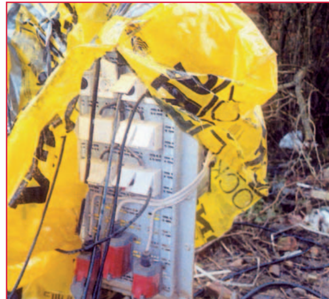
Unzulässiger provisorischer Baustromverteiler
