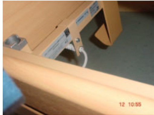
Abb. 38: Veränderte Kabelzuführung im Kopfbereich
